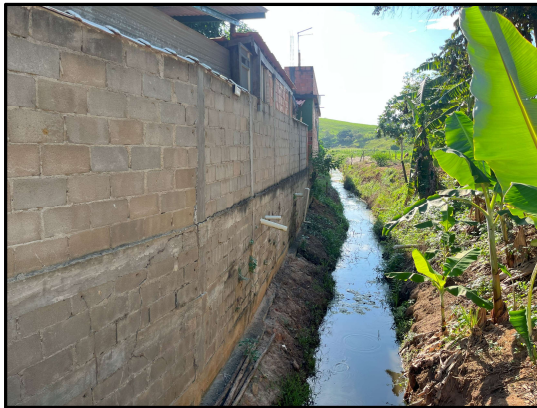
Imagem: Lançamento de esgoto doméstico em vala, em Bairro Scherrer.
